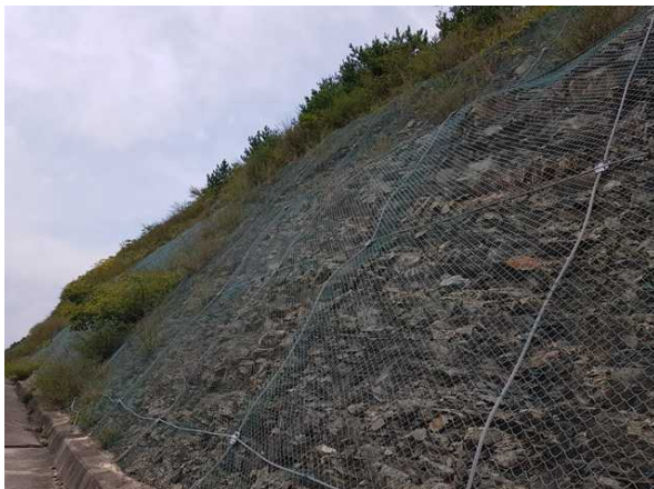
3단 풍화구간, 낙석방지망 전경
